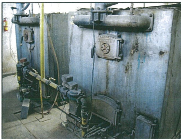
Zdjęcie 7 Widok kotłowni zasilanych paliwem gazowym.
