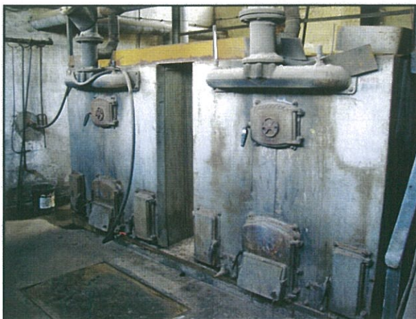
Zdj.8 Widok kotłów zasilanych paliwem stałym.
