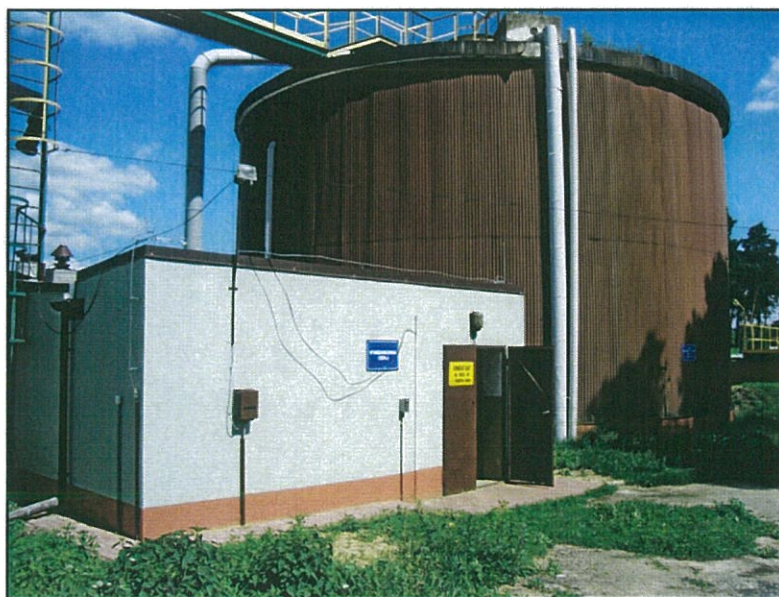
Zdj.4 Widok zbiornika z komorą fermentacyjną oraz budynkiem wymiennikowni ciepła i zespołu pompowego.
